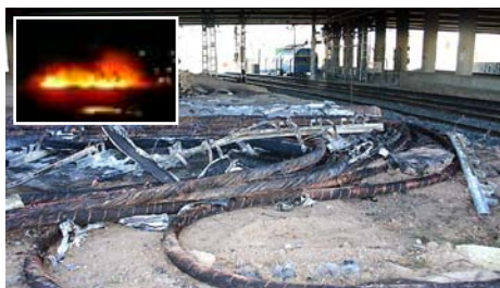
Incendio de los cables de alta tensión en el Bulevar Sur sobre la catenaria de RENFE el pasado 12 de marzo.
