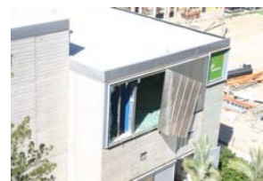
Rotura enrejado exterior provocado por la explosión 15 mayo 2007
